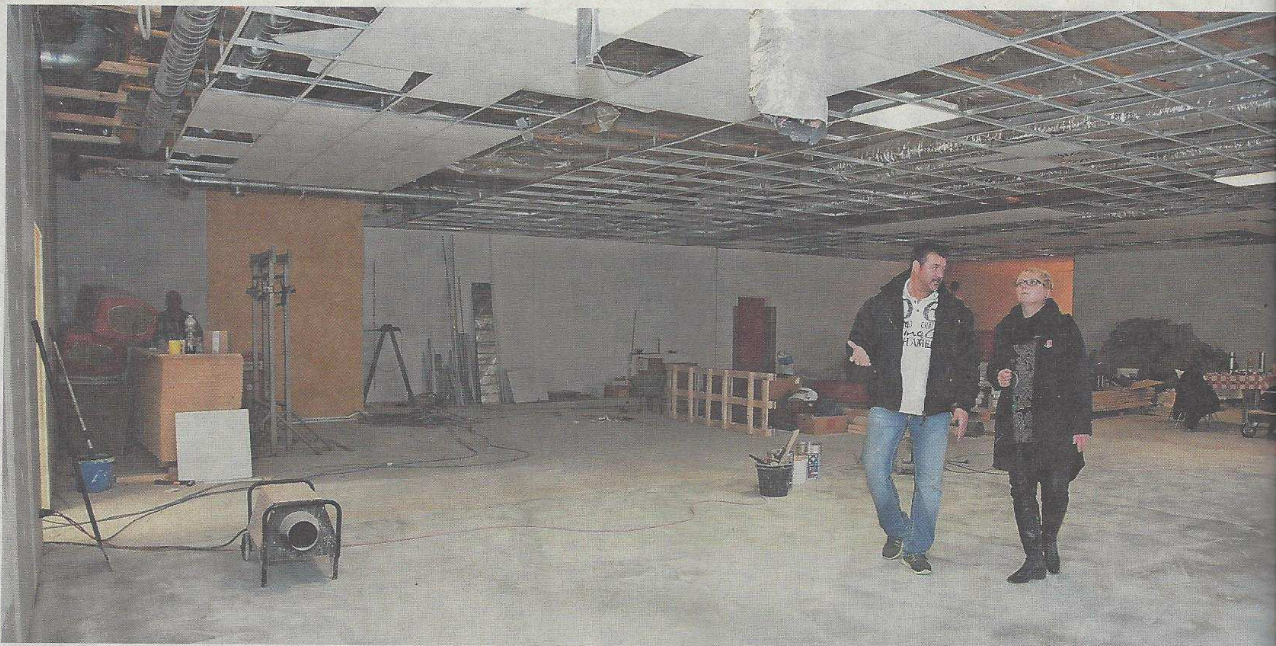
Wo derzeit noch dicke Löcher in der Decke klaffen, will Torsten Johanns im Januar das Herz seines Fitnessstudios, den Geräteraum, betreiben. Mit Claudia Allers vom Nordholzer Handwerksbetrieb Wilksen bespricht er die nächsten Sanierungsschritte. Fotos (2) Leuschner
